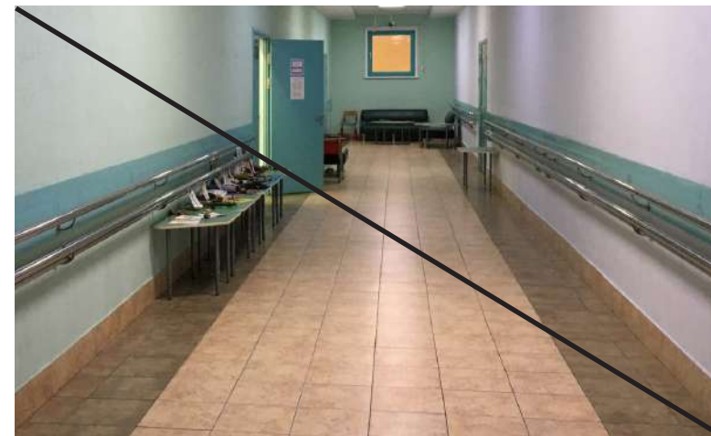
Плохо Керамогранитная плитка с крупными швами
